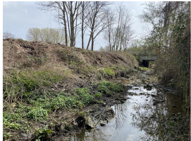
Abbildung 2-4: Östliche Böschung unterhalb des Einlaufbauwerks, nördlich der Straße „Am Kayenmühlengraben“
