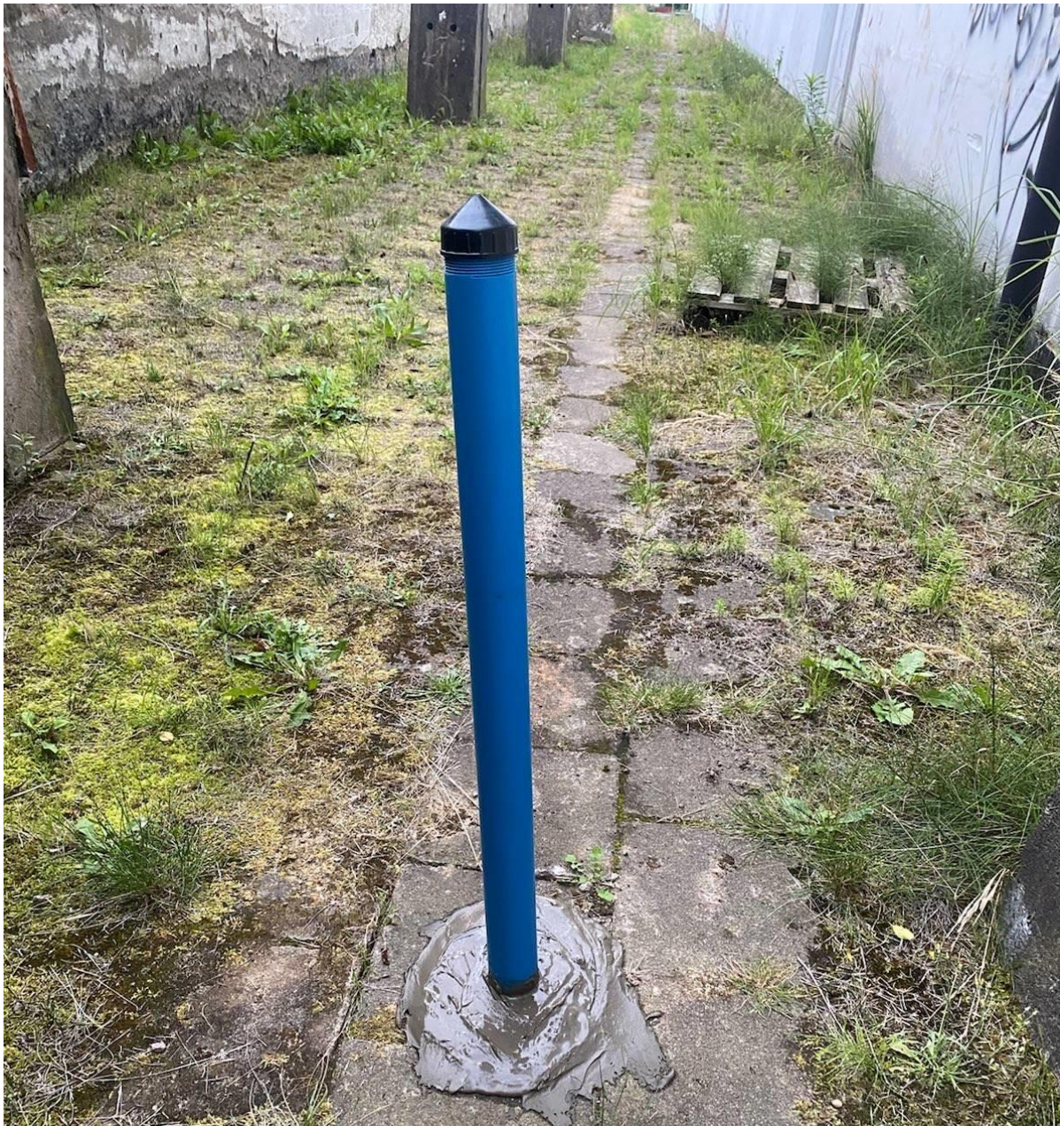
Abbildung 20 GWMS 3/20, repariert (Stand: 28.05.2021)
