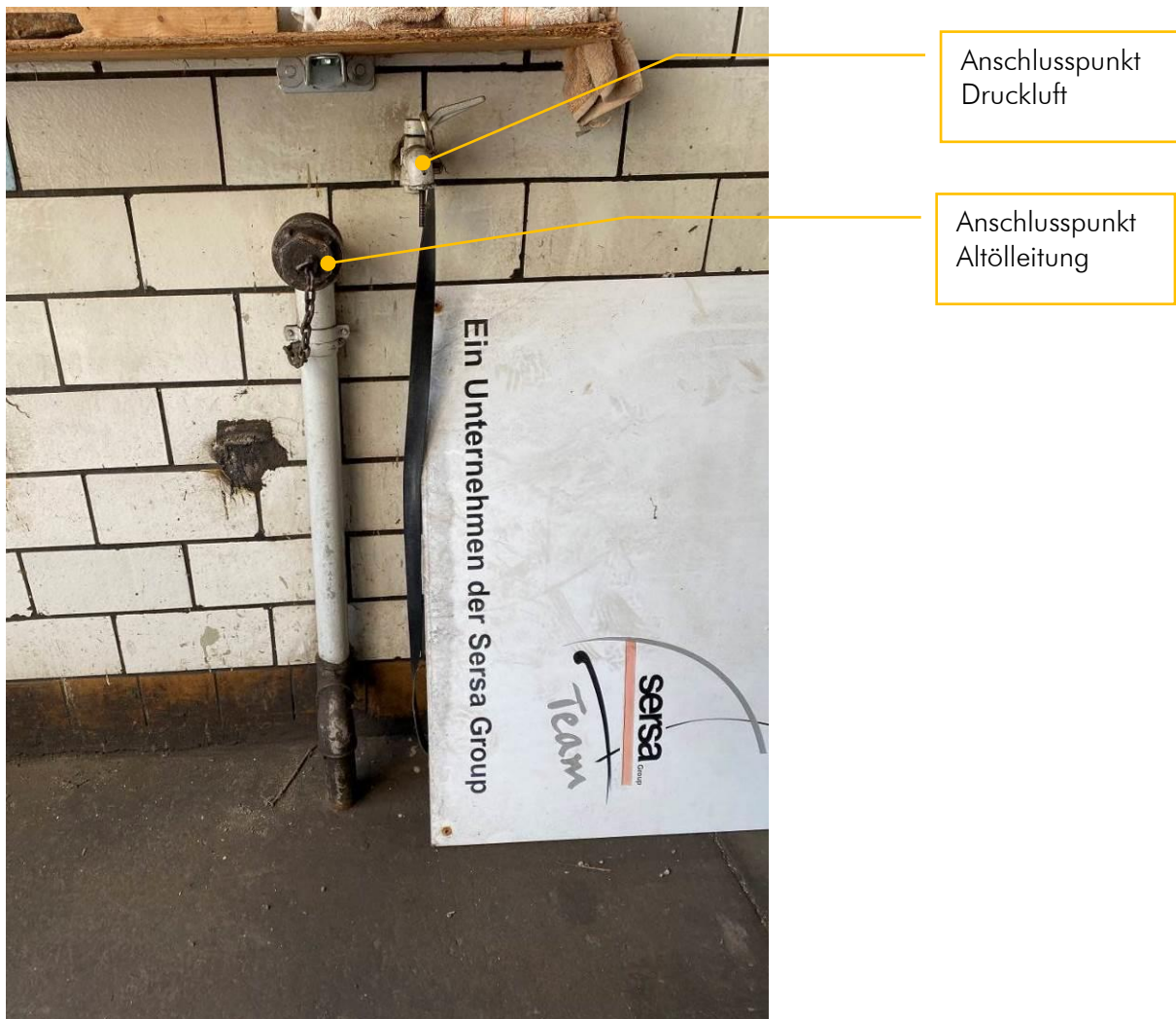
Abbildung 6 Anschlusspunkt Altölentsorgung Bereich PKW-Halle
