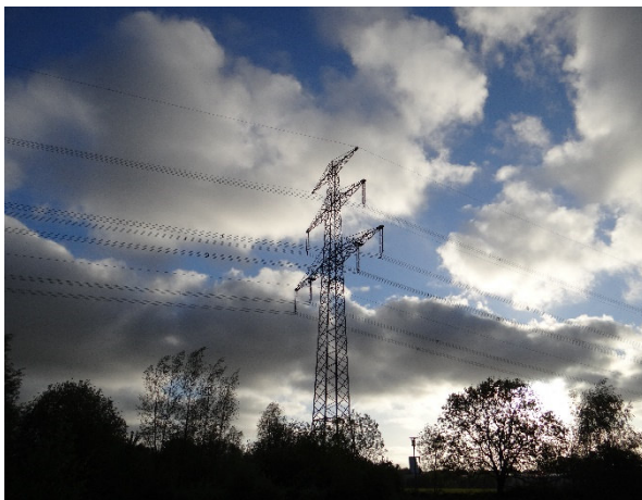
Abbildung 9: Strommast einer Hochspannungsleitung, 25.03.2019
