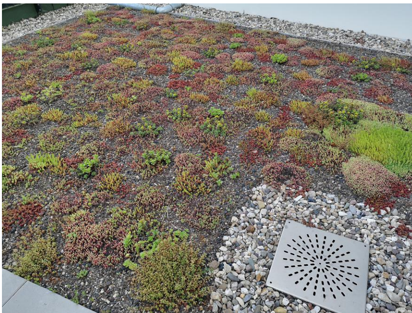
Abbildung 7-2: Extensives Gründach mit Überlauf (eigene Aufnahme)
